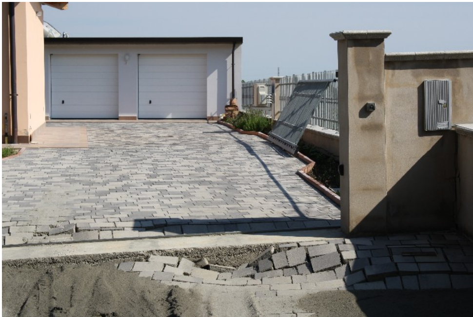
Fig. 8 – Abbassamento del suolo conseguente alla liquefazione in corrispondenza di un passo carraio a San Carlo (FE)
