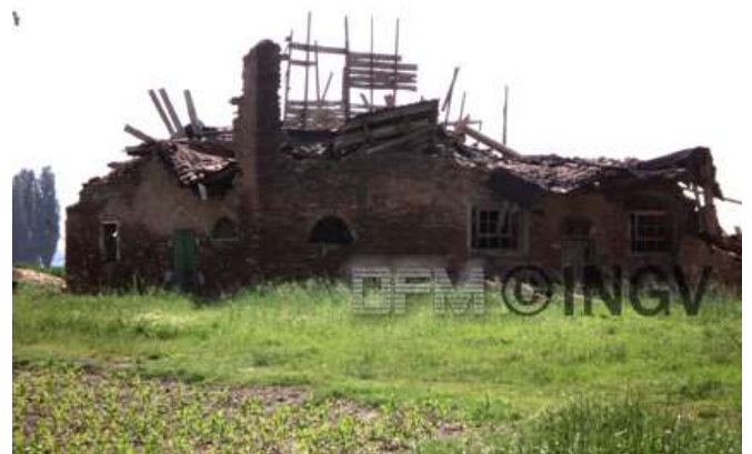
Foto 10. Pressi di San Carlo Crollo edificio di tipo A
