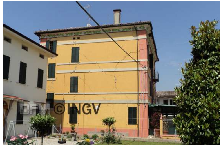
Foto 6. San Carlo Crepe larghe e profonde (grado danno 3)
