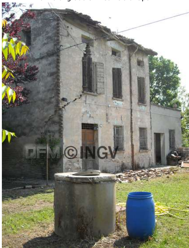
Foto 3. Canaletto Gravi danni in edificio vulnerabile di tipo A
