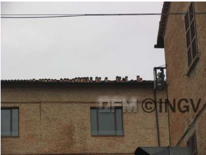
Foto 5. Mirandola Slittamento di tegole (grado danno 3)
