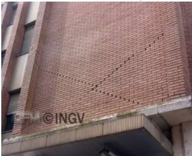
Foto 13. Cavezzo Danni di grado 3 in edificio in cemento armato
